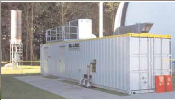
Unité de surpression biogaz, torchère
