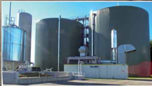
Digesteurs, unité de cogénération
