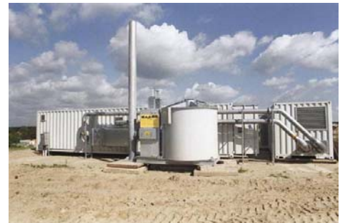
Vocsisbox ® biogaz sur C.S.D.
