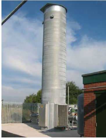
Torchère biogaz sur C.S.D.
