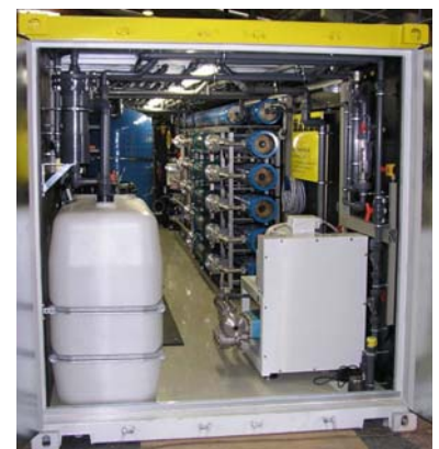
Vue intérieure d'un conteneur
